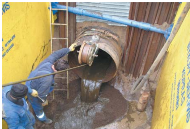
Fot. 3. Czyszczenie rurociągu po jego 40-letniej eksploatacji ze złożeń i odpadów pokorozyjnych
